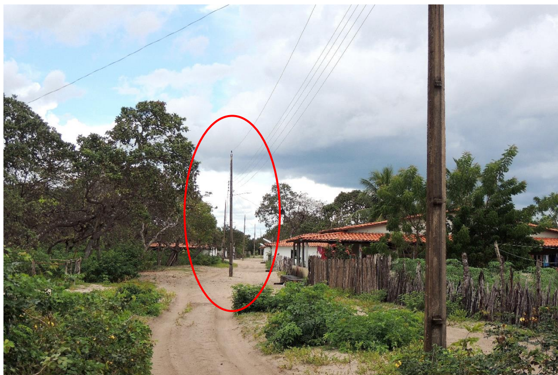
Figura 5 - Poste de energia instalado de forma irregular no povoado Massangano II
