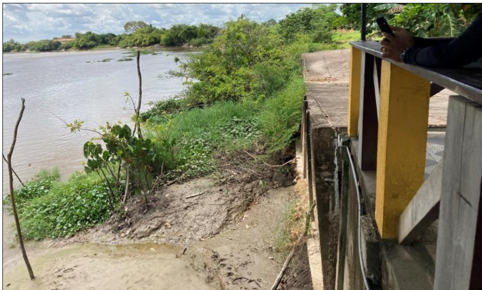
Figura 30: Solapamento da estrutura da calçada em Arari -MA, Brasil
