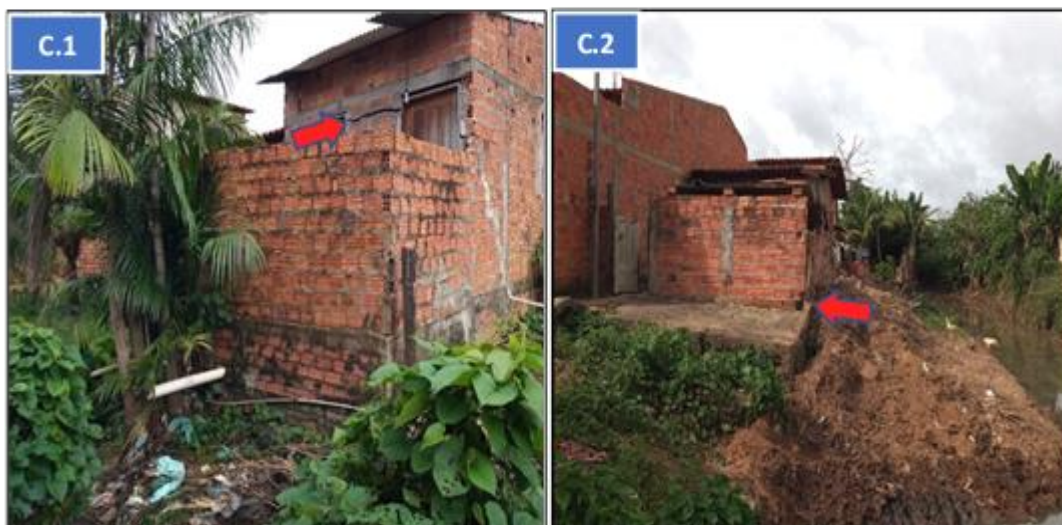
Figura 35 - Registros de danos nas edificações
