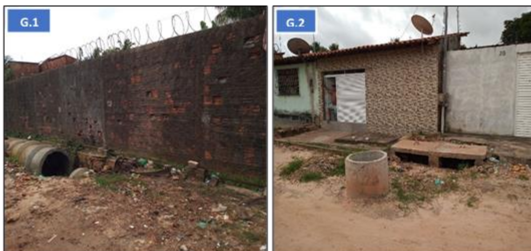
Figura 39 - Obras de drenagem não concluídas
