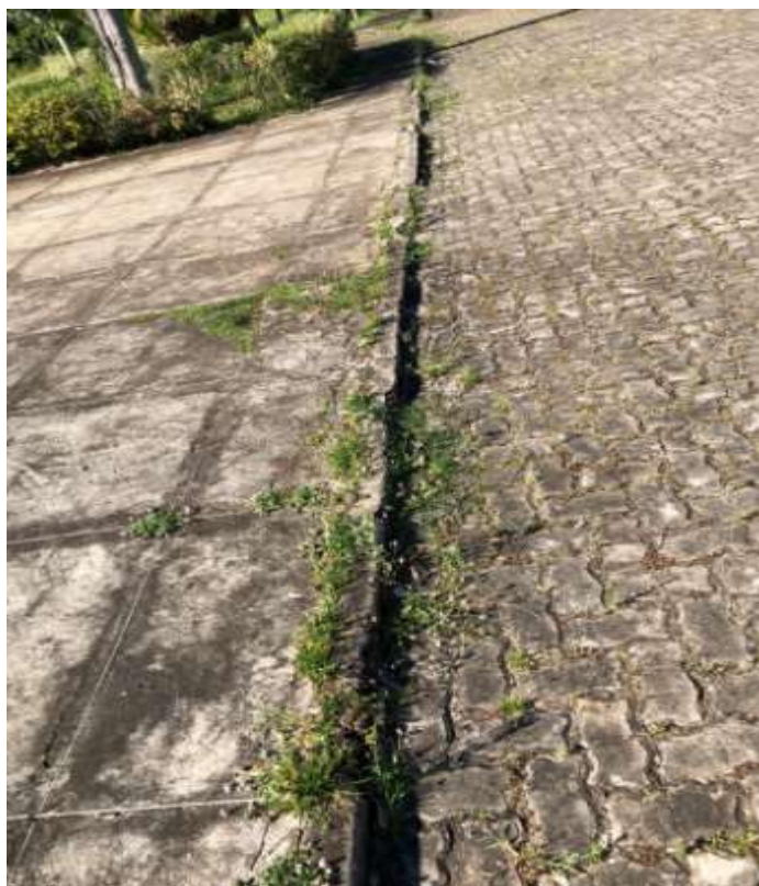
Foto 3 - Desnivelamentos no piso
