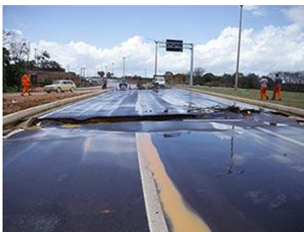
Figura 17: Trecho desabado na Via Expressa Fonte: g1.com.br
