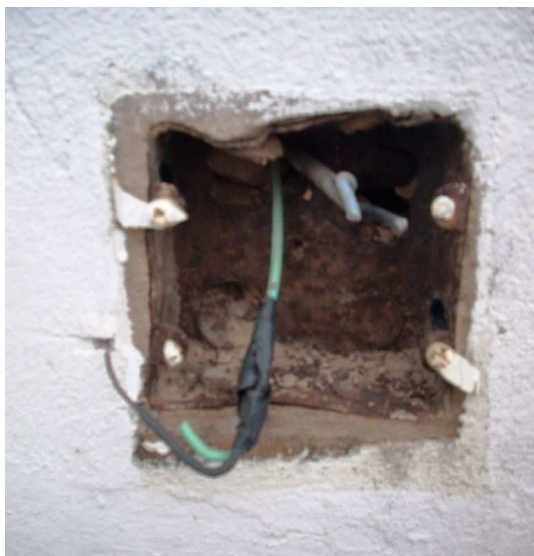
Caixa de passagem sem tampa expondo a fiação
