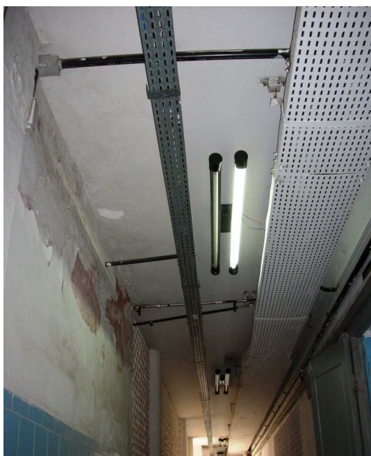
Luminárias de um mesmo circuito, acesas e apagadas
