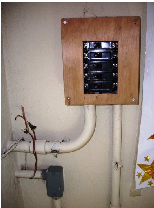
Quadro com proteção inadequada, em madeira
