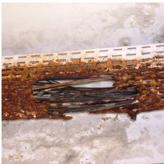
Eletrocalha em péssimo estado de conservação
