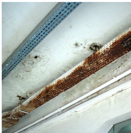
Eletrocalha em péssimo estado de conservação
