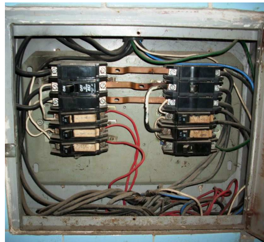
Quadros totalmente inadequados e inseguros
