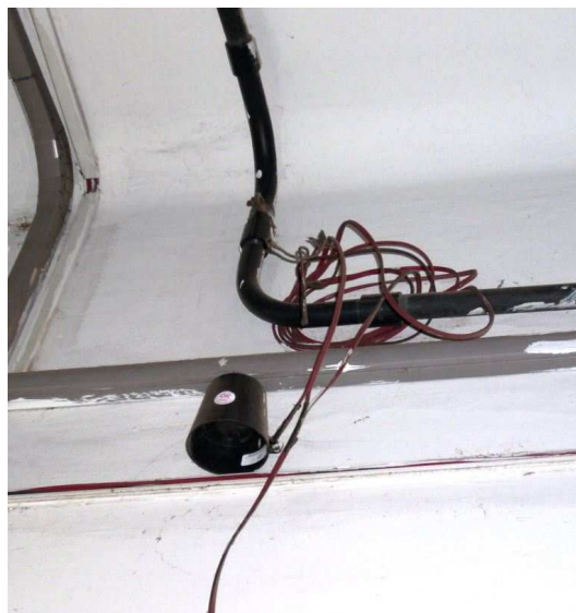
Conexões expostas e confusas
