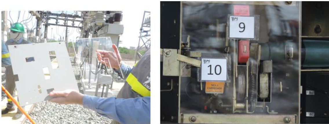
Figura 58 – Instalação de tampa de acrílico nas partes mecânicas do religador.
