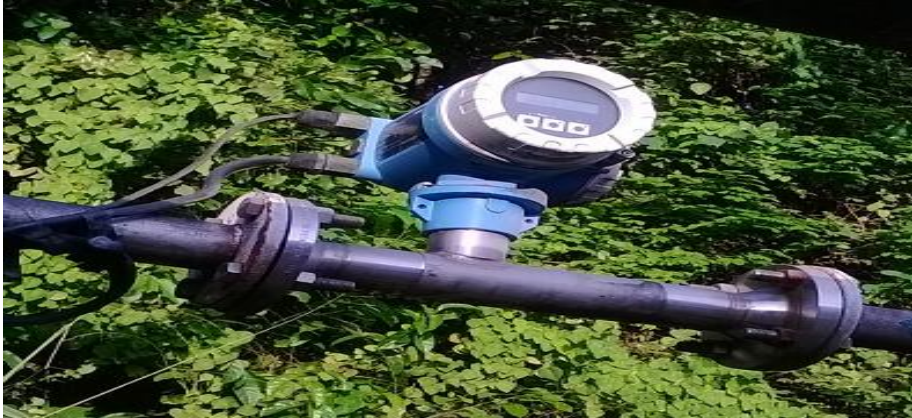
Figura 4 - Gasômetro (Medidor Biogás)
