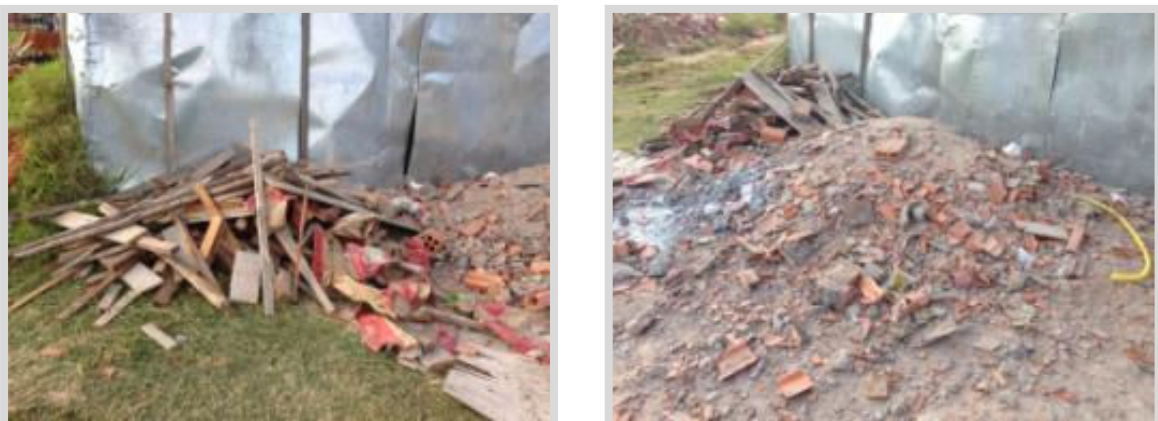
Foto 4 – Local de descarte irregular de resíduos da construção civil – Obra na área Universidade Estadual do Maranhão- UEMA. (27/05/2014)
