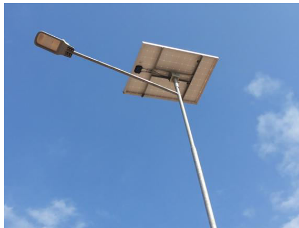
Figura 3.4 – Placa Solar instalada (Fonte: o Autor, 2013)
