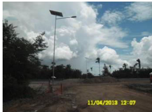
Figura 3.6 – Kit após Montagem dos Painéis Solares (Fonte: o Autor, 2013)
