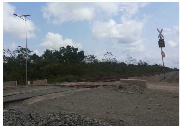
Figura 3.8 – Sistema Simples de Iluminação Instalado (Fonte: o Autor, 2013)
