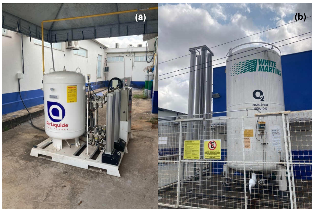
Figura 11: Unidades de armazenamento de (a) ar medicinal e (b) tanque criogênico de oxigênio localizado no Hospital Genésio Rego Fonte: do autor, 2025.
