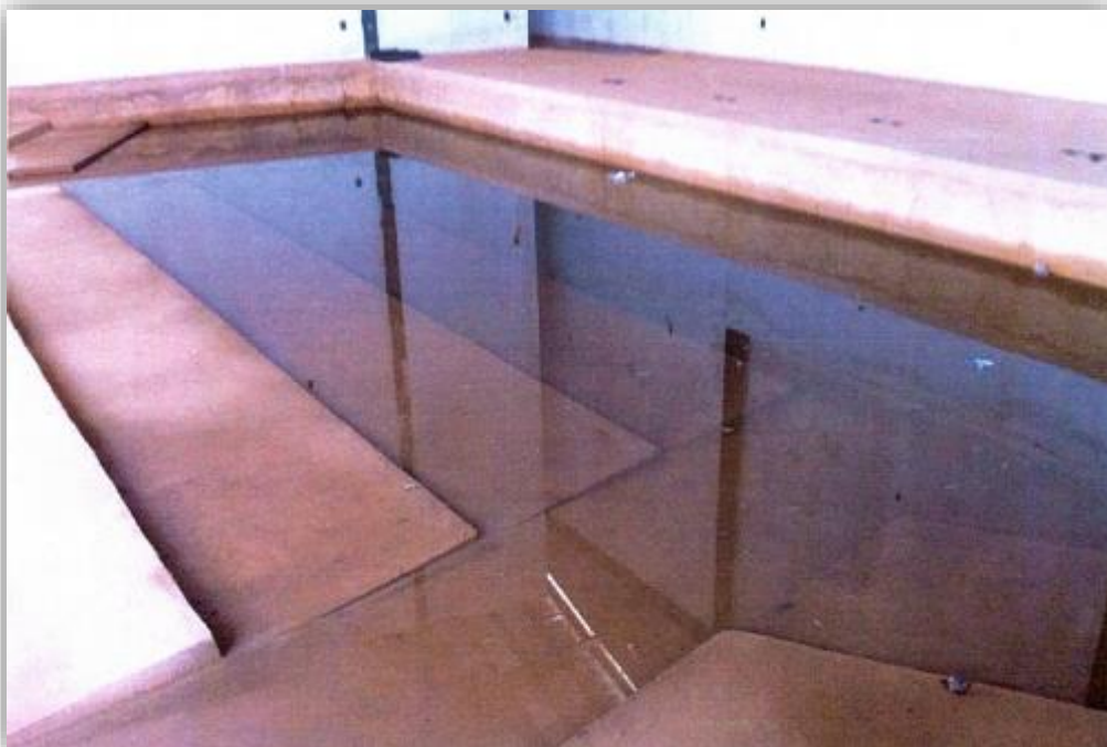
Figura 14 - Água da chuva invadindo a fábrica Santa Amélia
