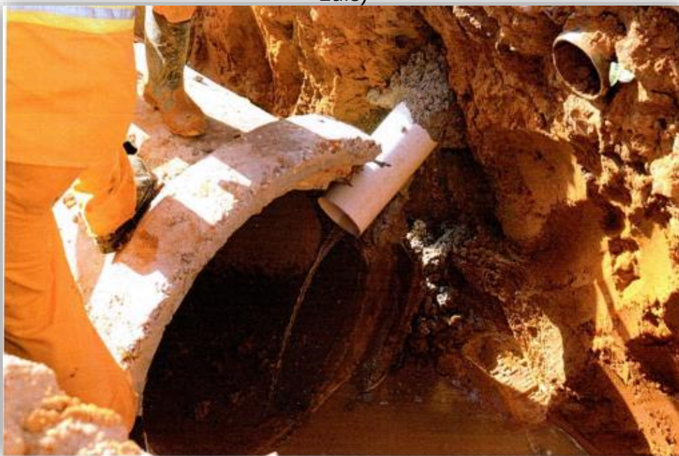
Figura 15 - Ligação das águas de esgoto na rede pluvial (obra da prefeitura de São Luís)
