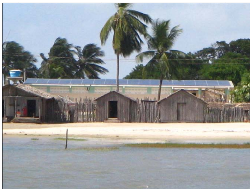
Figura 5.4 – Vista do gerador fotovoltaico.
