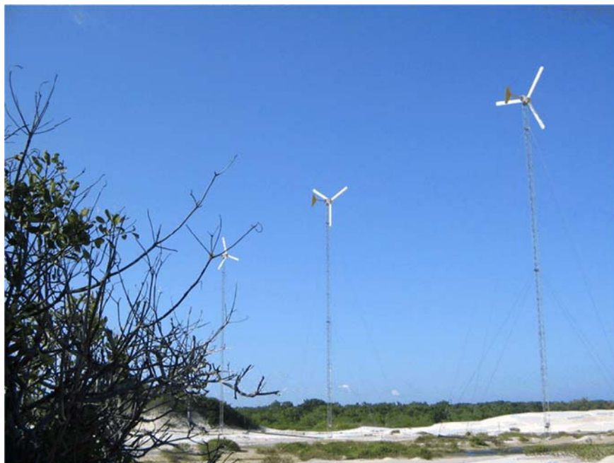
Figura 5.3 – Vista do local de instalação com as turbinas eólicas em torres de 30 m de altura.
