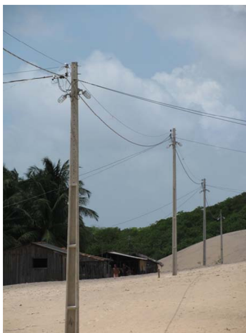
Figura 5.5 – Rede de distribuição de energia e iluminação pública.
