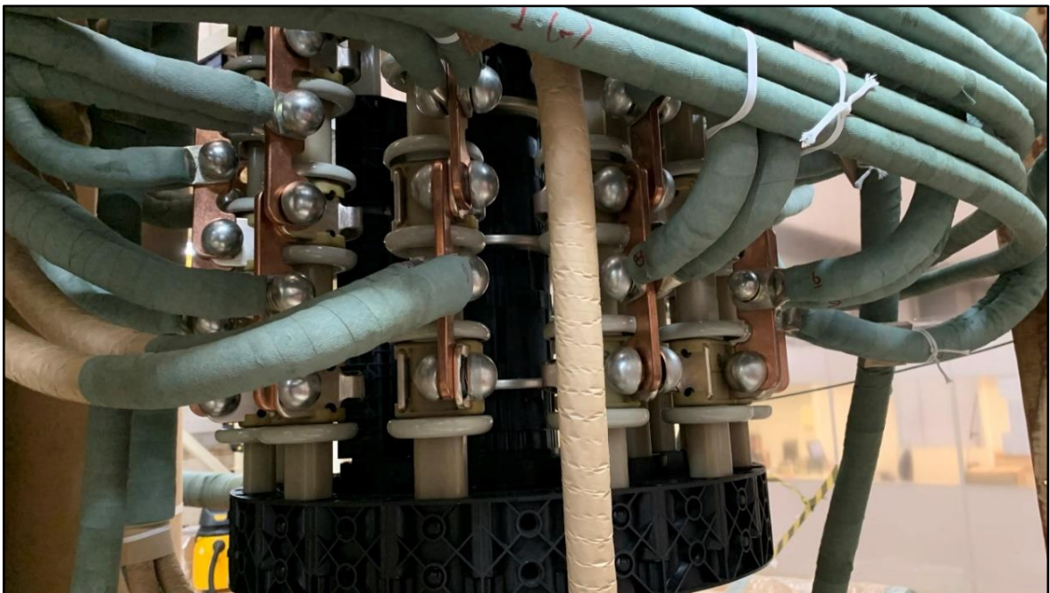
Figura 12: Conexões do comutador de um transformador de potência (Acervo do autor).
