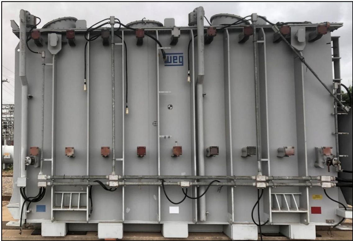
Figura 19: Vista do tanque de um transformador de potência de 230kV (Acervo do autor).
