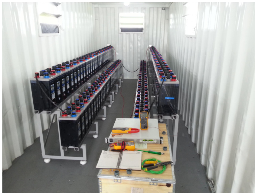
Figura 6-12- Banco de baterias.
