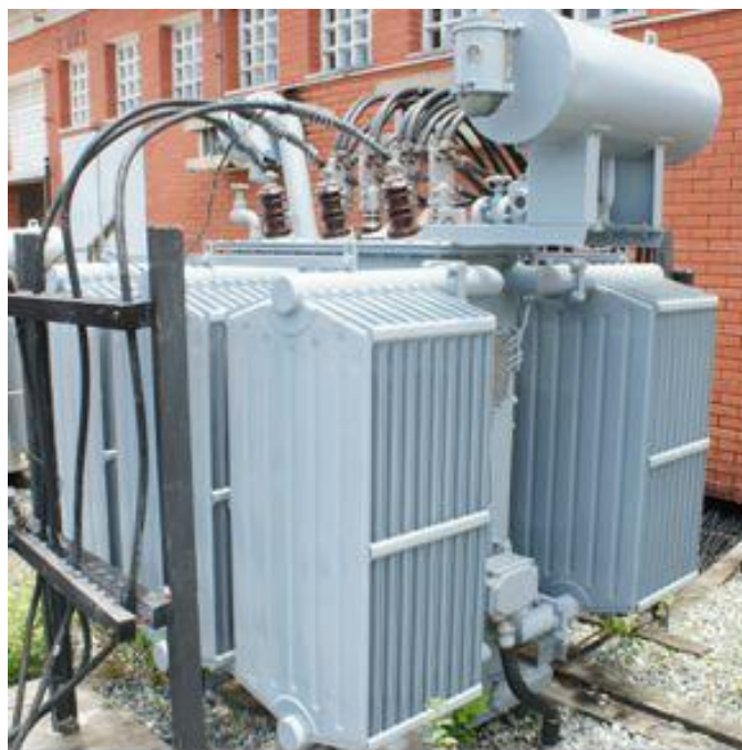
Figura 4.3: Foto do Transformador SE CT-CLA
