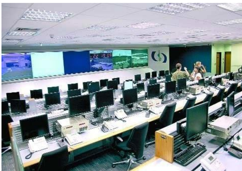
Figura 4.7: Centro de Controle Operacional do CT-CLA
