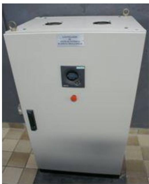
Figura 4.4: Foto do Banco de Capacitores SE CT-CLA
