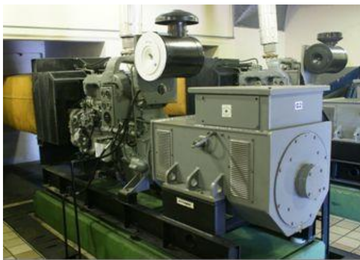
Figura 4.5: Foto do grupo gerador SE CT-CLA
