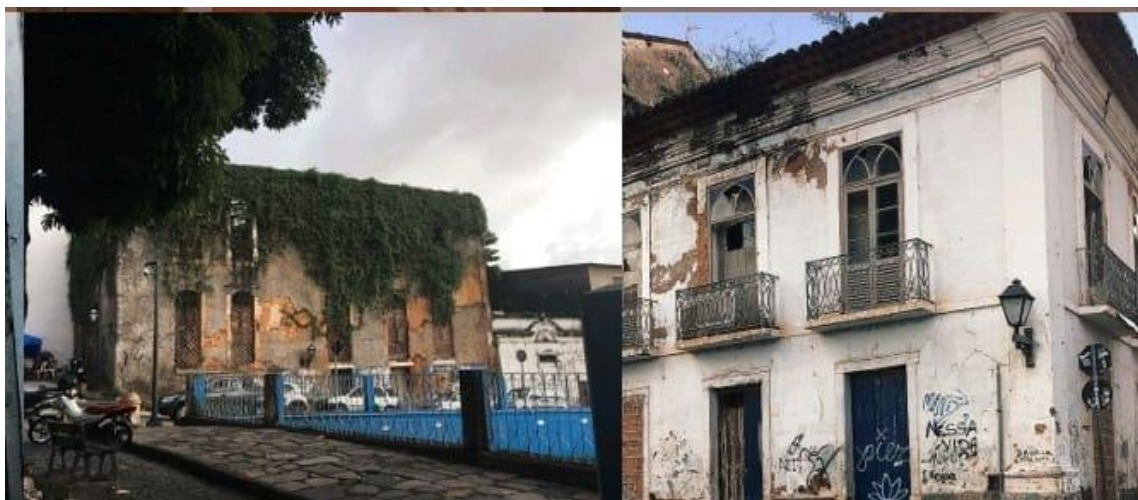
Figura 4 - Casarões deteriorados pela ação do tempo, intempéries e humana. Demonstrando a falta de manutenção e preservação desse patrimônio material.
