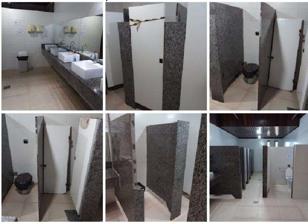
Figura 20: Fotomontagem mostrando os banheiros do CEPRAMA que necessitam de reformas e reparos.
