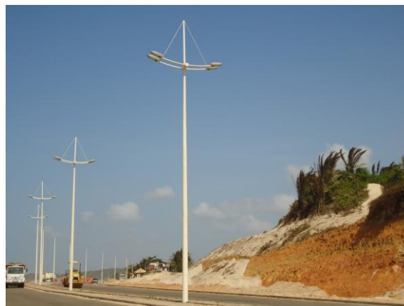
Figura 43: Sistema de iluminação
