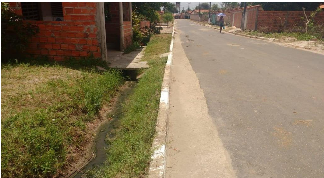
Figura 18 - Esgoto em sarjeta em borda de rua do município de Monção.
