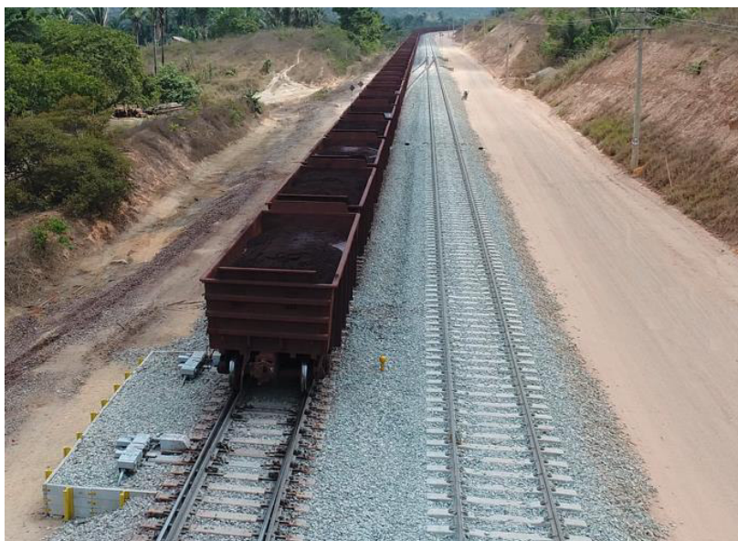
Figura 13 - Passagem de trem (cauda) pela região das Máquinas de Chave
