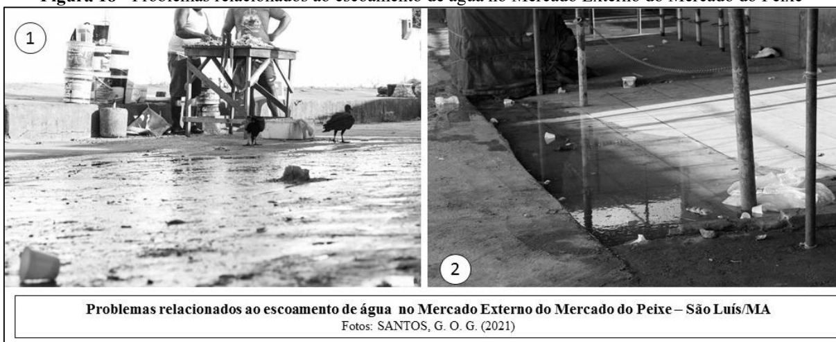
Figura 18 - Problemas relacionados ao escoamento de água no Mercado Externo do Mercado do Peixe
