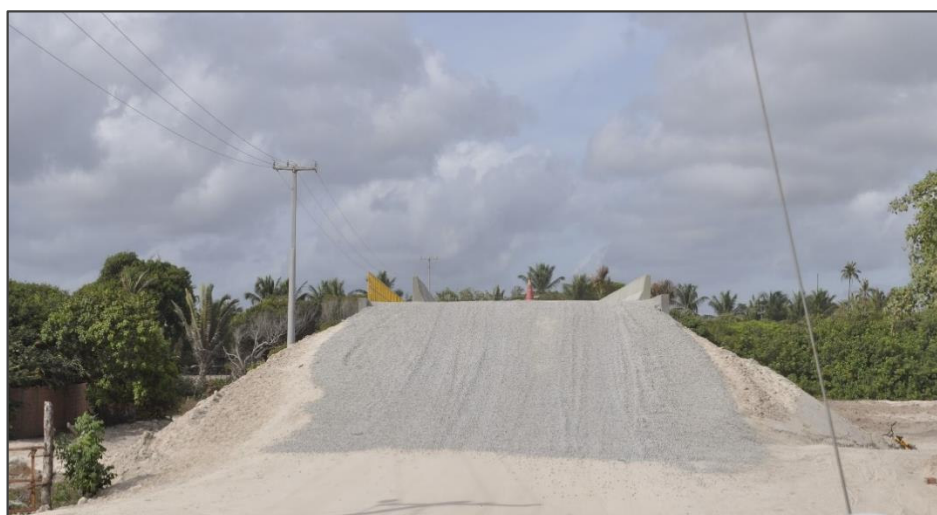
Figura 23: Cabeceira da ponte inacabada de acesso ao município de Santo Amaro.
