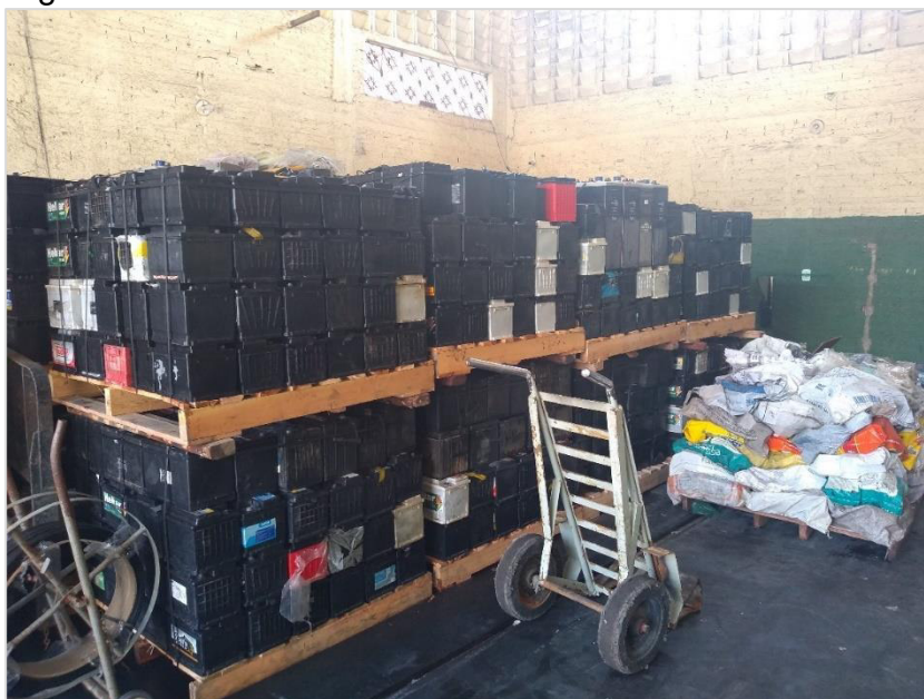
Figura 20 – Armazenamento de baterias inservíveis
