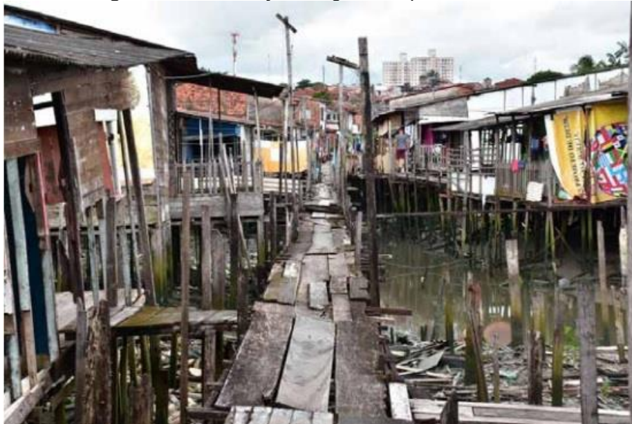
Figura 3 – Construção irregular de palafitas
