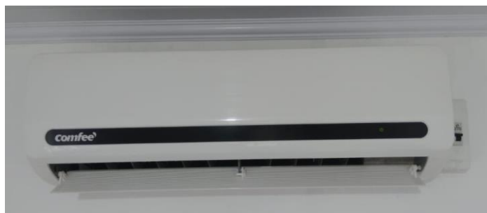
Figura 11 – Um ar condicionado deve ser instalado na parte superior, onde a evaporadora suga o ar quente que sobe por convecção e sopra ar frio (mais denso) que desce.
