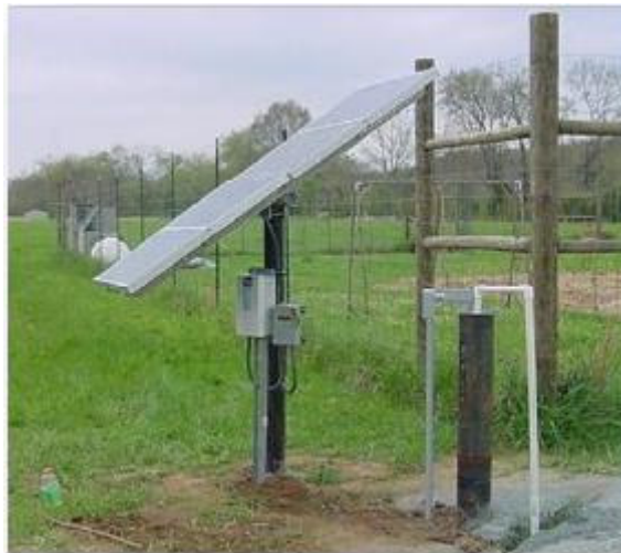
Figura 4 - Sistema de bombeamento fotovoltaico
