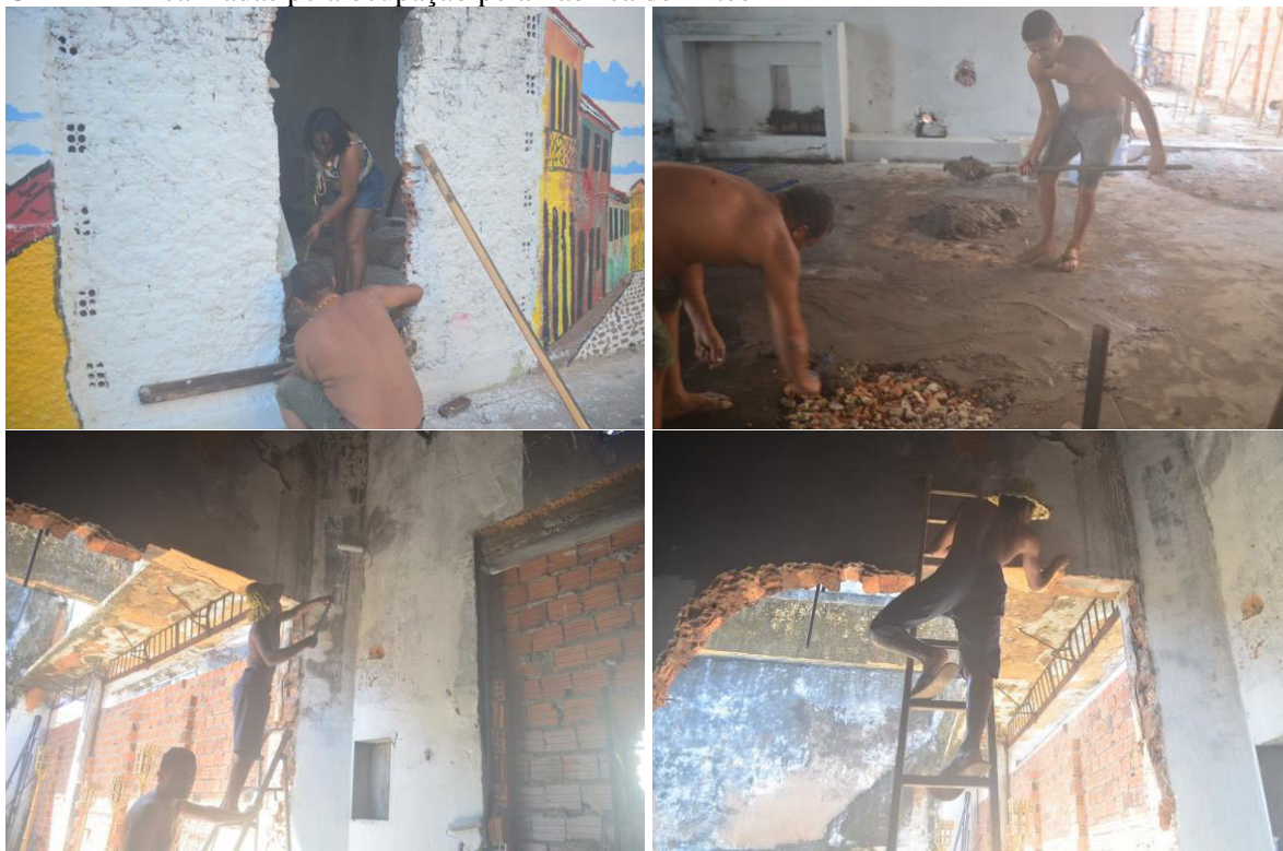
Figura 31 – Fotomontagem com as intervenções estruturais de manutenção do prédio da antiga OLEAMA realizadas pela ocupação pela Fábrica de Artes
