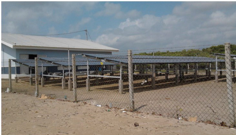
Figura 4.2 - Sistema fotovoltaico instalado em Ilha Grande [9]
