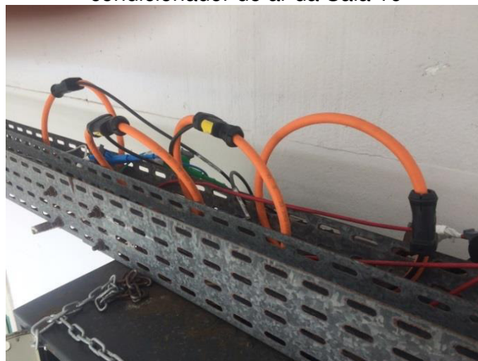
Figura 8 - Garras Transdutoras de Corrente instaladas nos condutores do circuito do condicionador de ar da Sala 16
