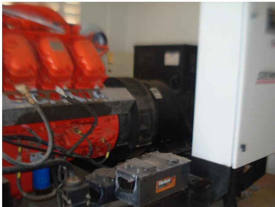
Figura 4.8 - Aspecto físico do grupo gerador subestação CCET
