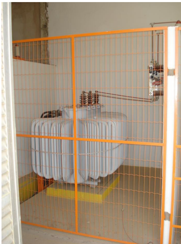
Figura 4.7 - Aspecto físico do Transformador da subestação CCET
