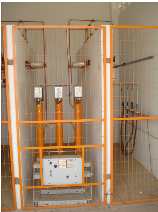
Figura 4.9 - Aspecto físico do disjuntor a PVO subestação CCET
