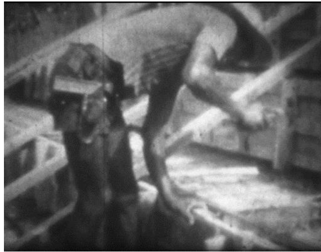
Fig. 19 - Trabalhadores sem EPIs
