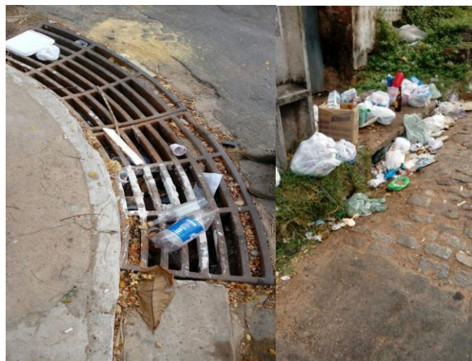
Figura 18- Pontos de drenagem na parte baixa da fábrica próximo ao Mercado Central bloqueados pelo lixo.
