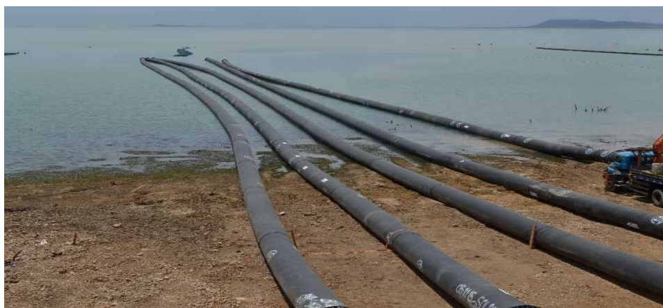
Figura 20: Sistema de captação de água por Flutuantes
