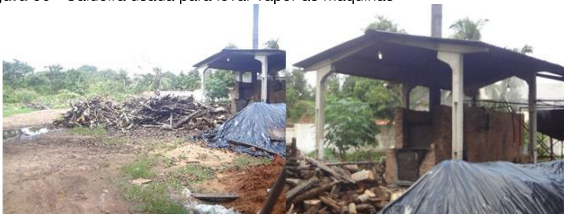
Figura 56 - Caldeira usada para levar vapor as máquinas
