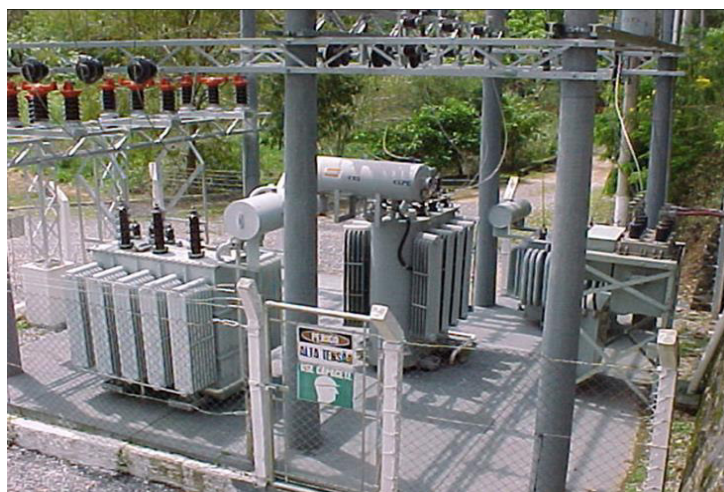
Figura 3.5: Subestação de média tensão.
