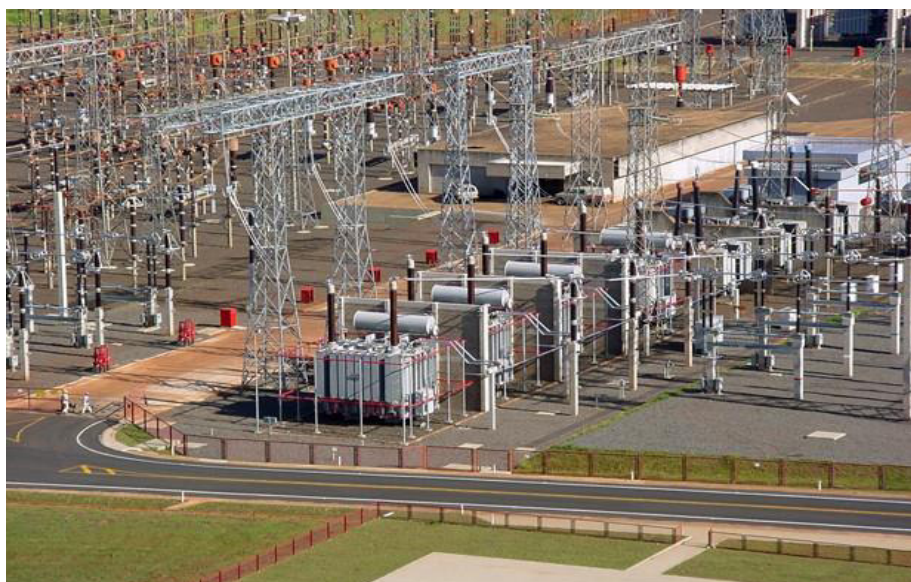
Figura 3.6: Subestação de alta tensão.
