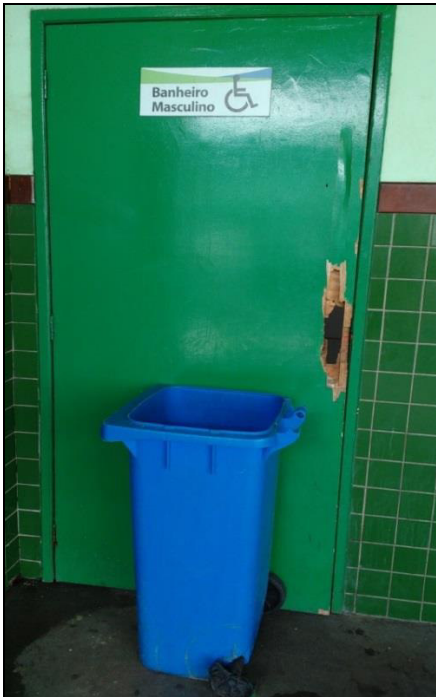
Imagem 2: Banheiro masculino no Terminal de Integração Cohab/Cohatrac. Observa-se que a porta está com defeito, não tem fechadura, e o usuário fica praticamente exposto no momento de fazer suas necessidades fisiológicas. Foto: SANTOS, D. S, 2016.
