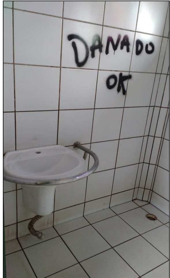
Imagem 5: Área interna do banheiro feminino no Terminal Cohab/Cohatrac. Nota-se que a pia está com problema na encanação. Fonte: SANTOS, D. S. 2016.
