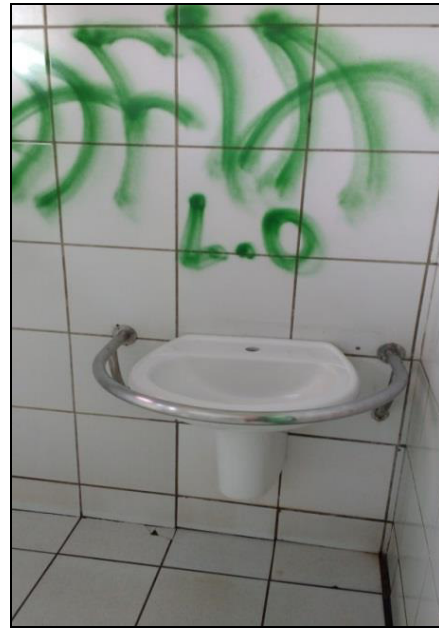
Imagem 3: Área interna do banheiro masculino Terminal Cohab/Cohatrac. Percebe-se a presença de utensílios adaptados, mas também nota-se a existência de pichações e de rachaduras no piso. Foto: SANTOS, D. S, 2016.
