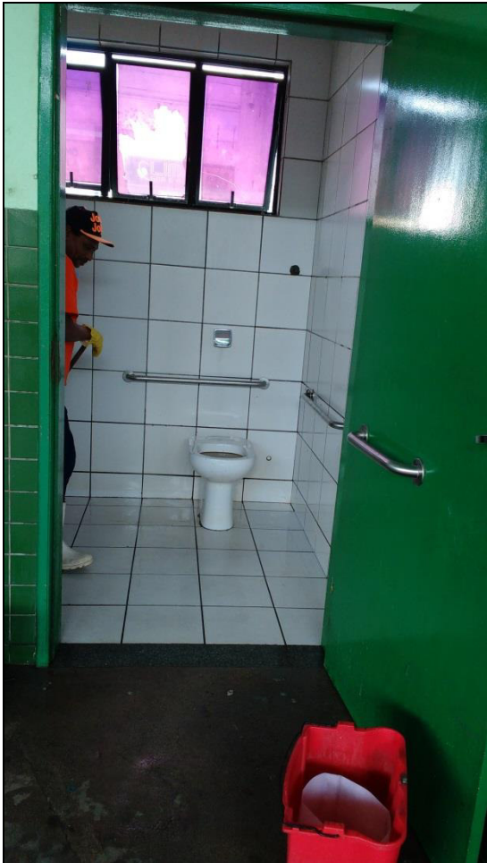
Imagem 4: Banheiro feminino no Terminal Cohab/Cohatrac. Mas, o vaso sanitário está com problemas no sistema de descarga. Fonte: SANTOS, D. S. 2016.
