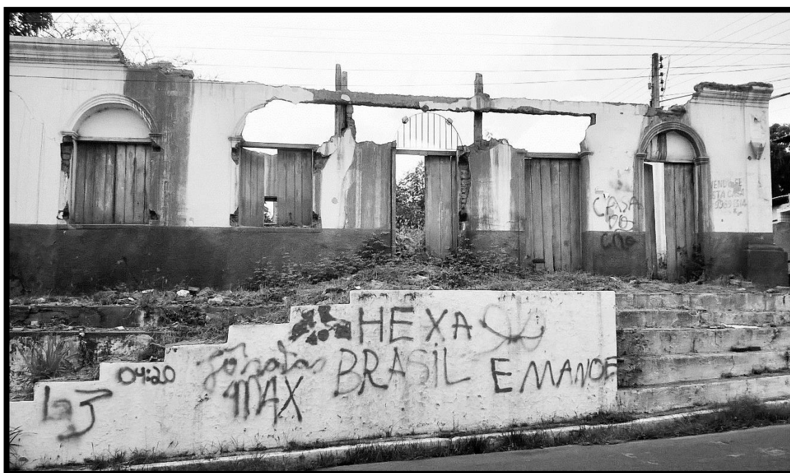
Imagem 48 - Casarão em ruínas no centro de Barra do Corda, MA. Fonte: Acervo do autor.
