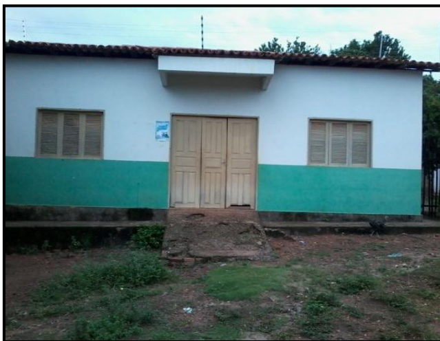
Figura 5- Rampa de acesso sem corrimão, área externa da UBS-B*. Imperatriz, 2016.
