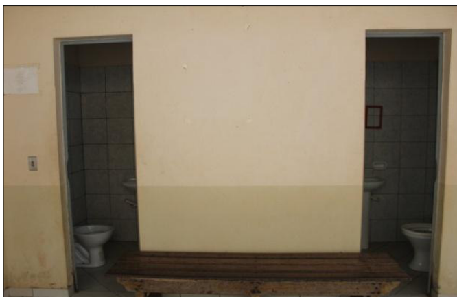
Figura 6– Banheiro não adaptado, área interna de UBS. Imperatriz, 2016.
