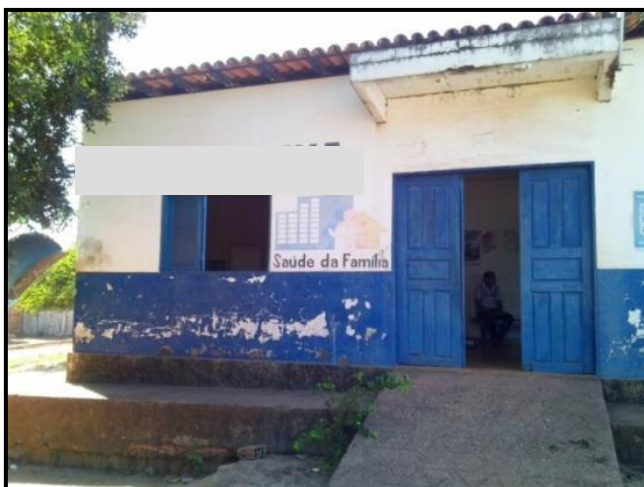
Figura 4- Rampa de acesso sem corrimão, área externa da UBS-B*. Imperatriz, 2012.
