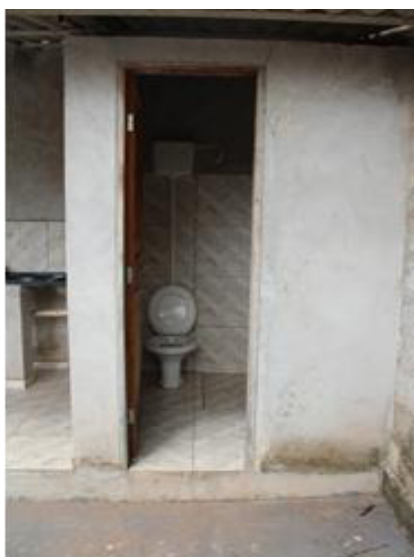
Figura 7 - Banheiro não adaptado, área interna de UBS. Imperatriz, 2016.
