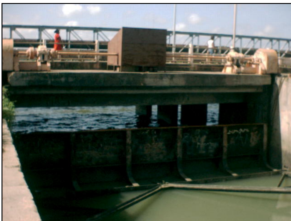
FIGURA 9: Comporta fechada da barragem. (Fonte: RHANSAR, 2007)
