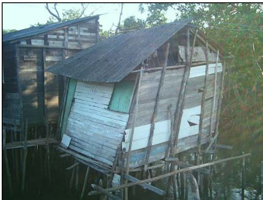
FIGURA 7 – Palafita em situação de risco na Rua São Sebastião Na comunidade do Japão. (Fonte: PCA, 2005)
